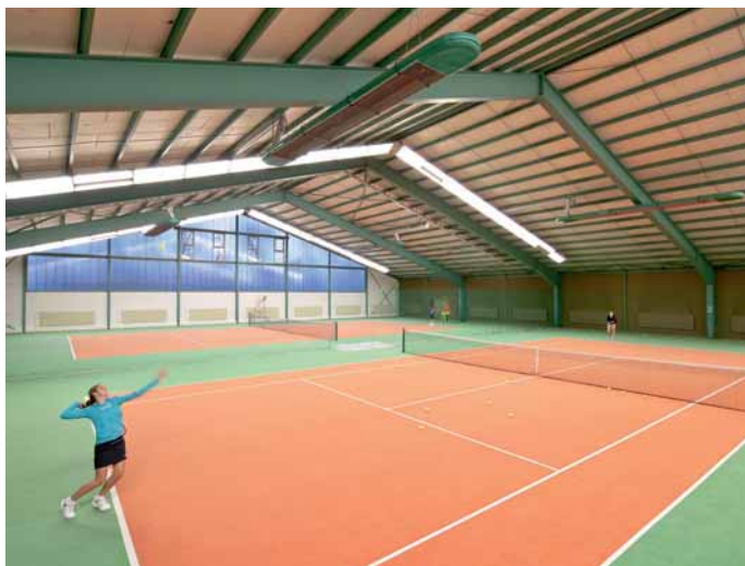
Die grün lackierten Infrarot-Heizstrahler passen sich ins Gesamtbild der Tennishalle ein.
