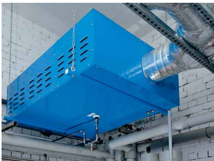
Mit der Restwärme aus der Hallenheizung wird über einen Wärmetauscher Warmwasser erzeugt und in einen Pufferspeicher geleitet. Dadurch kann der Hallenvorraum mit beheizt und die Warmwasserversorgung der Sanitärräume unterstützt werden.
