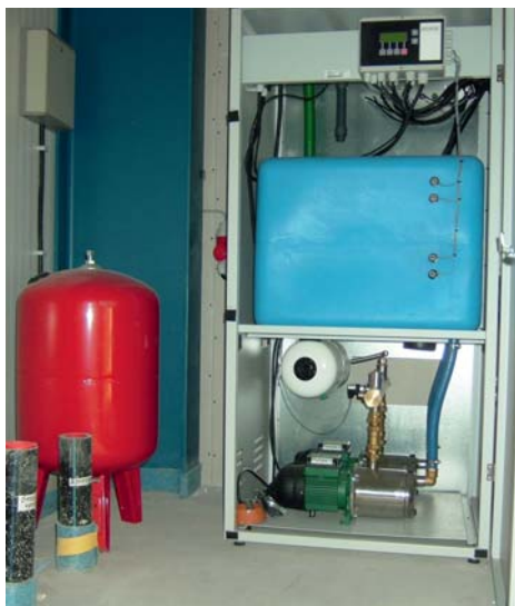
Druckerhöhungsanlage Tano XL im Keller der Gebäude als Teil der Grauwasseranlage mit automatischer Trinkwassernachspeisung bei leerem Entnahmebecken
