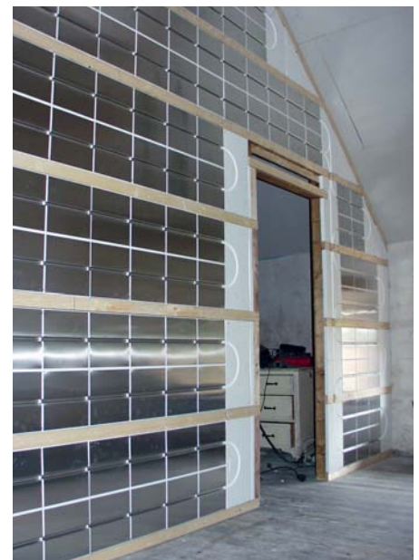
Dieser Raum wurde mit einer Wandheizung in Trockenbauweise ausgestattet.
