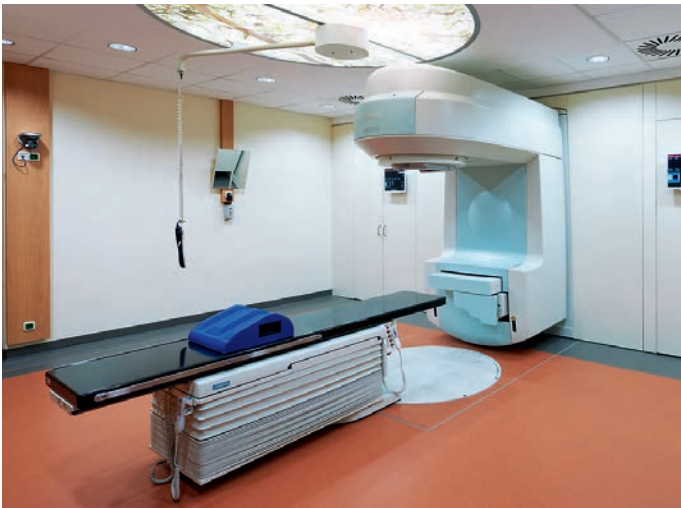
Der Linearbeschleuniger erzeugt eine Wärmelast von rund 25 kW, die abgeführt und zur Raumerwärmung genutzt wird.
