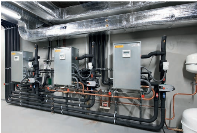
Das Herzstück der Anlage mit den drei Wasser-Wärmetauscher-Einheiten
