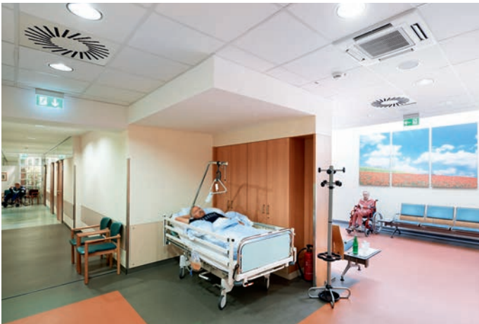
Im Wartebereich sorgen Lüftung und Umluftklimageräte für angenehme Temperaturen.
