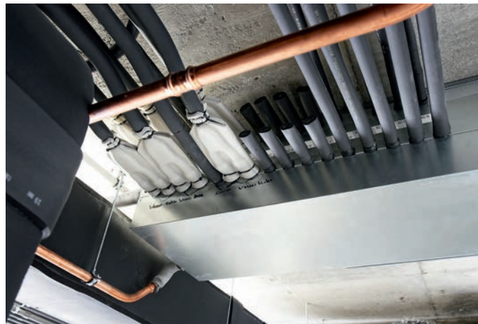
Der Kältemittelverteiler (BC-Controller) verteilt Wärme- und Kälteenergie innerhalb des Neubaus dorthin, wo sie benötigt wird.
