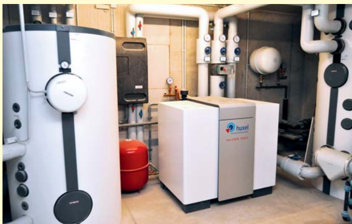
Die Wärmepumpenanlage im Paulus-Haus besteht aus einer Sole/Wasser-Wärmepumpe mit Pufferspeicher, dem 750 l-Trinkwarmwasserspeicher und einer effizienten Trinkwasser-Ladestation.
