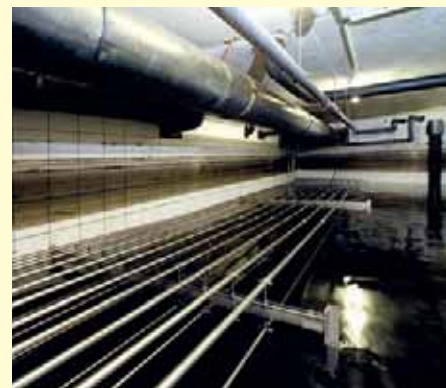
Das Absetzbecken mit 29 °C warmem Rückspülwasser, das aus der Filteranlage kommt. Es gibt vor dem Abfluss seine Wärmeenergie über einen Wärmetauscher im Becken an den Kältekreislauf der Wärmepumpe ab.
