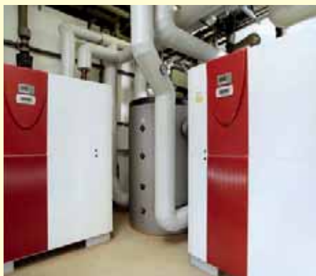
Die beiden Wasser/Wasser-Wärmepumpen WI 100TU von Dimplex im Heizungskeller des Thermalbads benötigen keinen seitlichen Mindestabstand und bieten variable Anschlussmöglichkeiten an der Gehäuserückwand.
