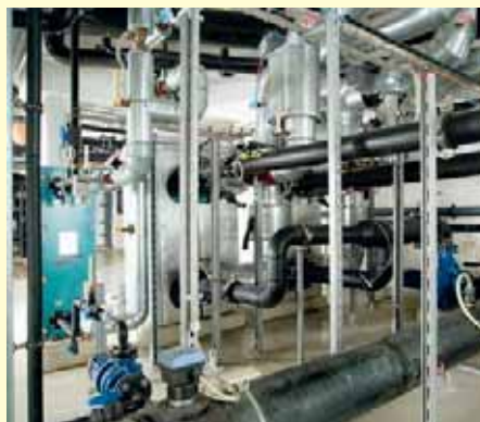
Links im Bild sind die Wärmetauscher zu erkennen, über die die Wärme an die Innen- und Außenbecken der Ardesia-Therme übertragen wird.
