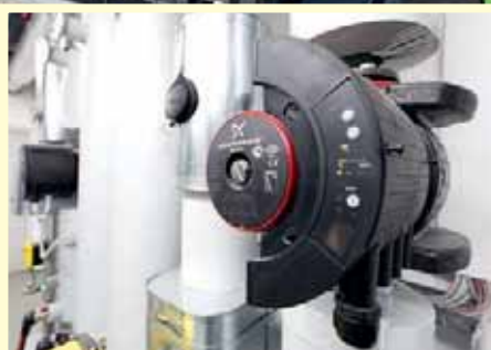
Heizkreisstation mit Umwälzpumpe zur Versorgung der Fußbodenheizungsflächen
