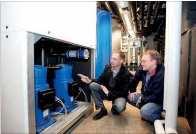
Der Geschäftsführer der Heizungsfachfirma Both GmbH (links) erklärt Gerd Paffhausen, Geschäftsführer der Camping Laacher See GmbH, die Funktionsweise der Sole/Wasser-Wärmepumpe.
