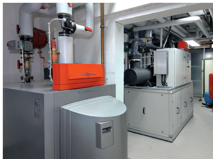
1 – Bivalente Heizungsanlage mit Gas-Brennwertkessel und Wasser/Wasser-Wärmepumpe
