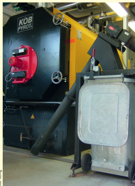
Pelletheizkessel mit automatischer Asche-Austragung
