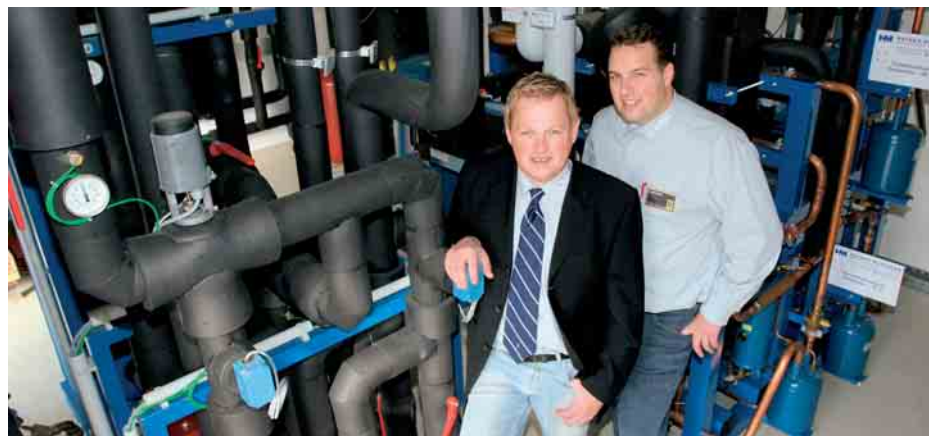
2 Die hohe Abwärme aus der Kälteerzeugung war für die Geschäftsführer Gerd und Klaus Koch schon immer ein Dorn im Auge. Jetzt heizen sie mit „Abfallwärme“.
