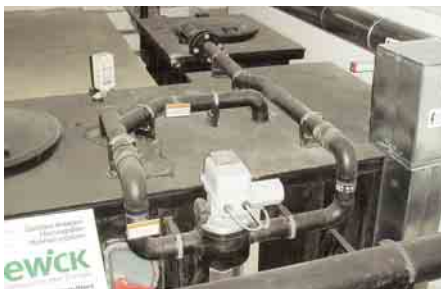
④ Maßgeschneidert über Eck eingebaut: Die engen Einbauverhältnisse erforderten planerische Kreativität und technisches Know-how.
