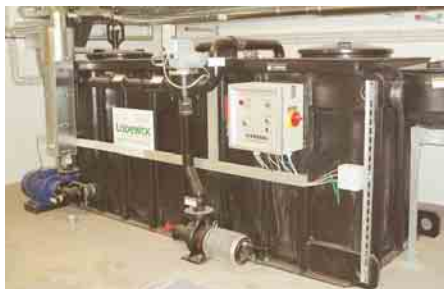
③ Große Strecke, starke Pumpe: Wegen der langen Entsorgungsleitung entschied sich das Projektteam für eine besonders starke, vom Fettabscheider getrennte Entsorgungspumpe.
