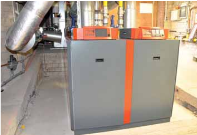
Der Doppelkessel Gas 610/9 ECO mit einer Leistung von 1.062 kW erhielt einen gemeinsamen Abgasanschluss.
