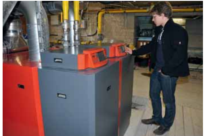
Das Kesselschaltfeld erlaubt eine komfortable Bedienung und ermöglicht einen einfachen Blick auf den aktuellen Betriebszustand.
