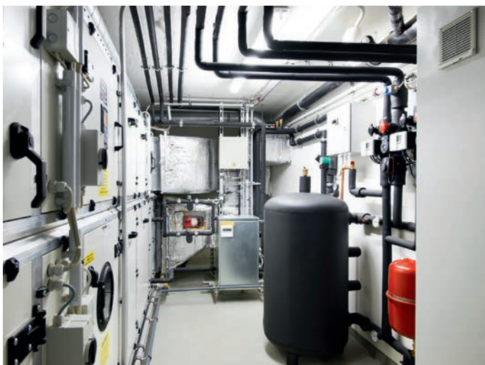
Im Technikraum neben der Tiefgarage sind alle zentralen Komponenten der Klimaanlage untergebracht.
