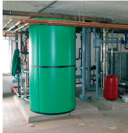
7 Der EuroCondens-Kessel und der Warmwasserspeicher von CT-Therm beanspruchen im Verhältnis zur ursprünglichen Heizanlage zusammen nur wenig Raum.
