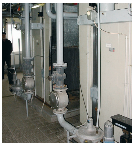
② Zwei atmosphärische Kessel (je 1.150 kW) bildeten die extrem überdimensionierte Altanlage aus dem Jahr 1979, die nicht mehr die vorgeschriebenen Abgaswerte erfüllte.
