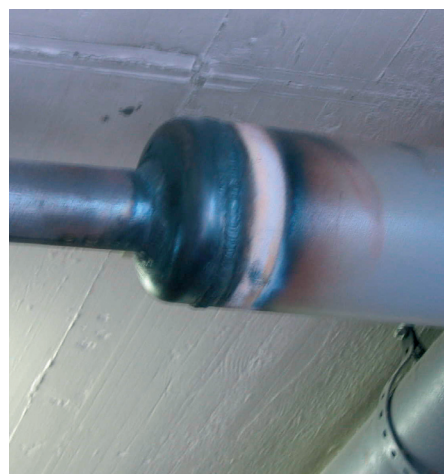
8 Schon die gewaltige Reduzierung der Gaszuleitung lässt erkennen, welches Einsparpotenzial hier gegeben sein muss.
