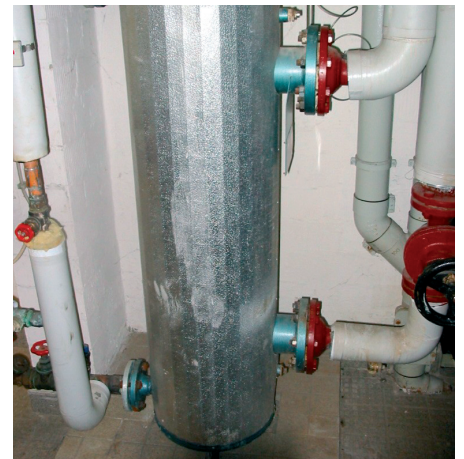
③ Wegen der zwei Warmwasser-Gegenstromapparate (hier einer im Bild) musste die Systemtemperatur ganzjährig auf 80 °C gehalten werden.
