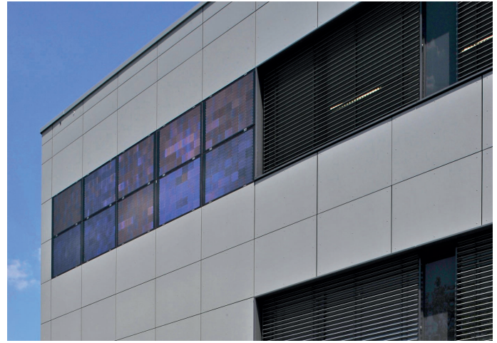
6 – Laborgebäude: PV-Module mit HIP-MWT Solarzellen
