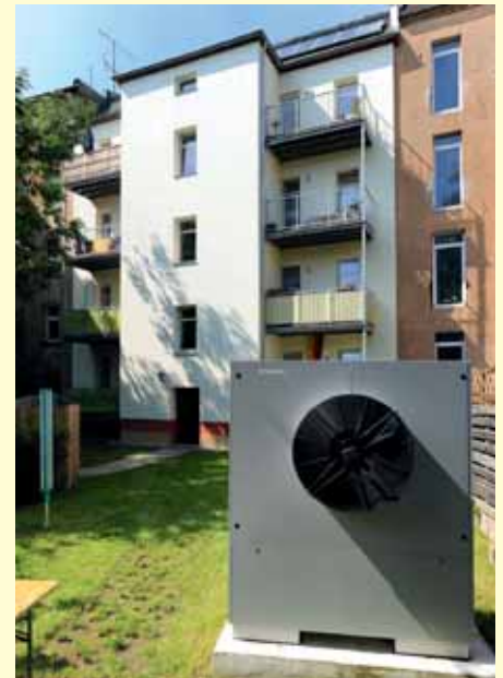
Dimplex Luft/Wasser-Wärmepumpe LA 40TU im Hinterhof eines sanierten Mehrfamilienhauses in Leipzig. Alle Wohnungen konnten bereits in der Bauphase aufgrund der sehr geringen Heizkostenberechnungen erfolgreich vermietet werden.
