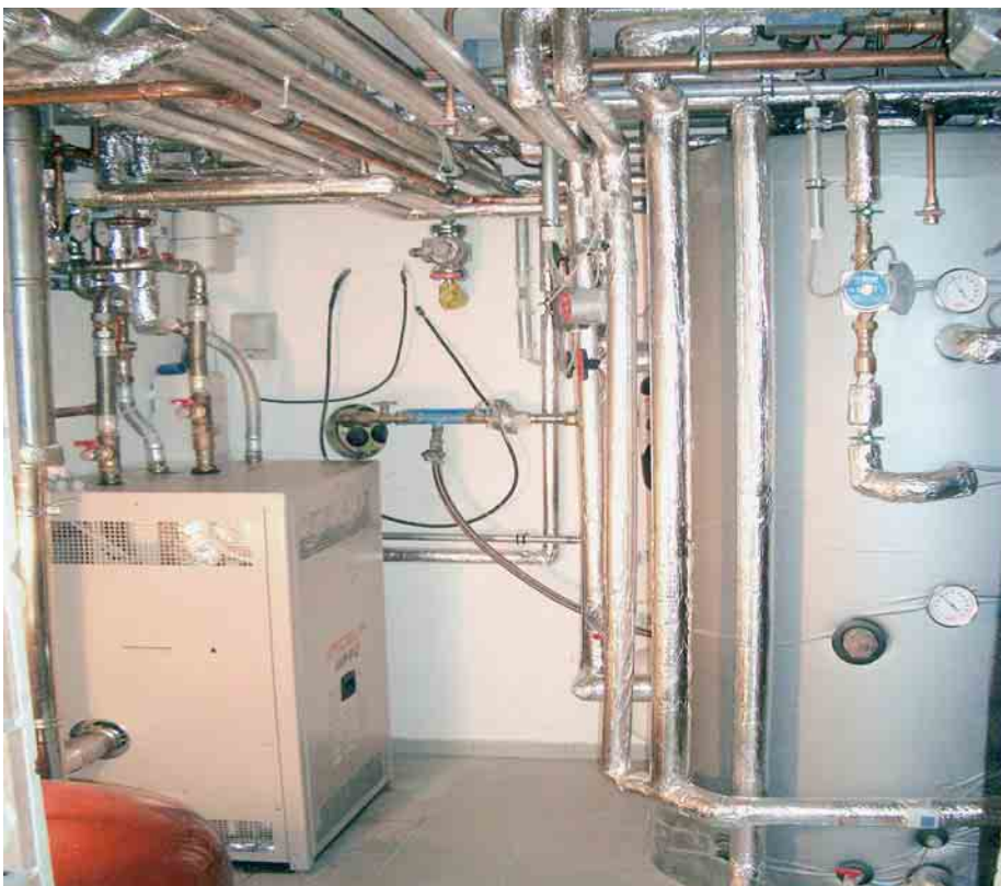
Die Gas-Absorptionswärmepumpe erzeugt gleichzeitig Kälte und Wärme.
