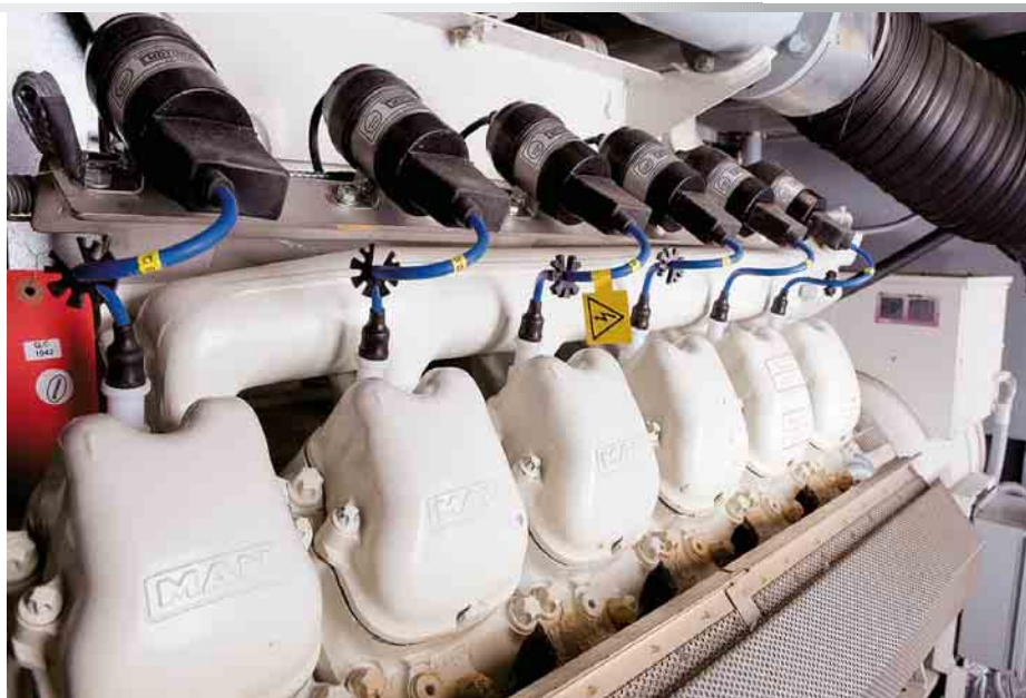
Das Blockheizkraftwerk liefert die Energie für die Absorptionskältemaschine.
