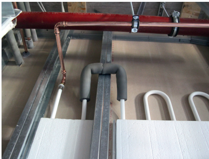
Anbindung des Elements an den Heizkreislauf
