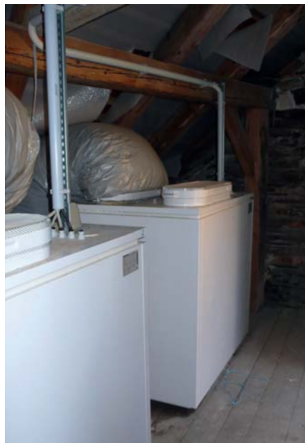
Für die Energieerzeugung sorgen Luft/Wasser-Wärmepumpen mit einer Leistung von je knapp 15 kW.
