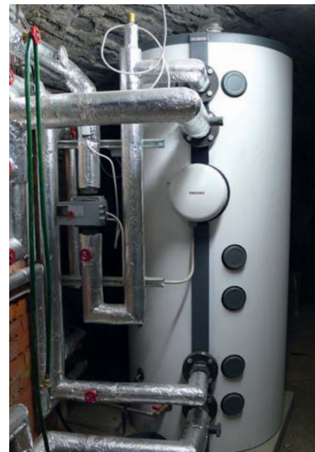
Zwei Pufferspeicher mit je 1.000 l Fassungsvermögen versorgen die Flächentemperierung zuverlässig mit warmem Wasser.
