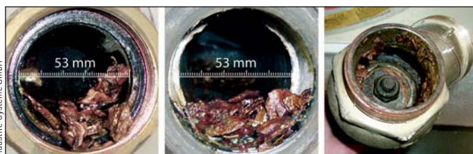
Ablagerungen und Partikel in unterschiedlichen Bestands-Löschwasseranlagen für die Hydrantenversorgung
