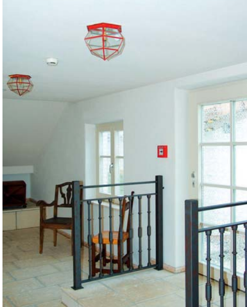
Neben rund 200 automatischen Brandmeldern kommen auch Druckknopfmelder zur manuellen Alarmierung zum Einsatz.
