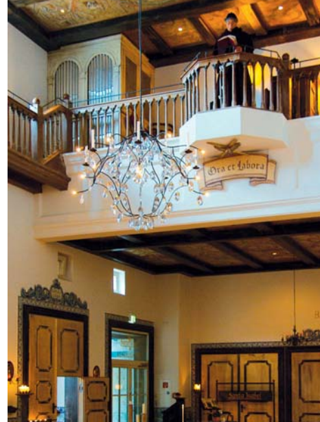
Hinter der Orgel-Attrappe ist der Ventilator zur Entrauchung verborgen.
