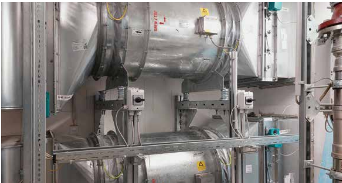
BEISPIEL redundante Zuluft- ventilatoren in Köln, Messecity Rossio Ost 2
