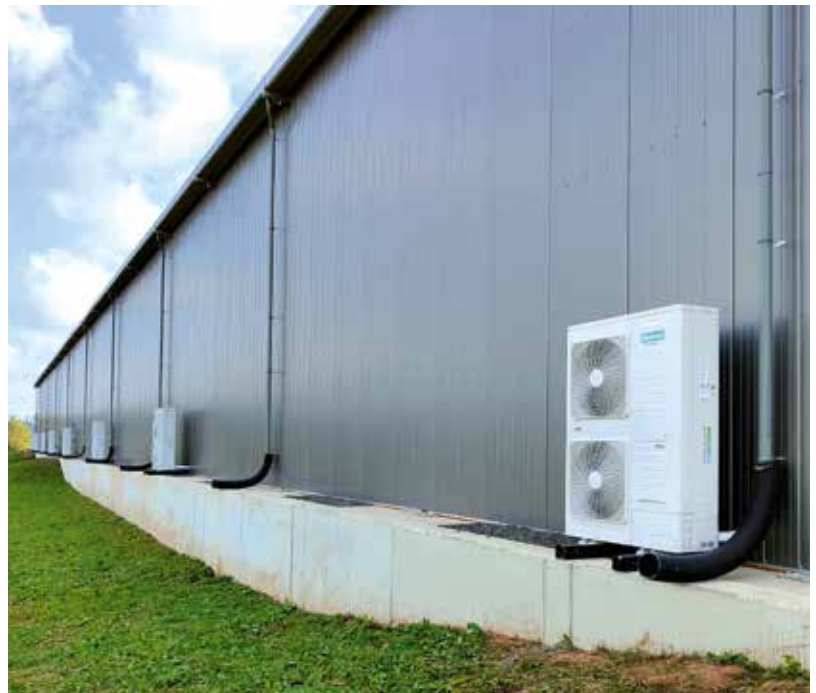
Acht PAC+ Außengeräte von Hisense sorgen für optimale Lagerungsbedingungen
