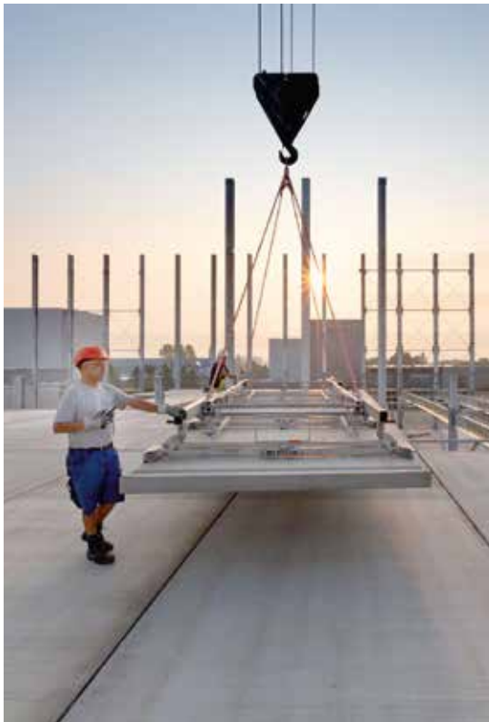
Montage einer Deckenplatte. Die Module werden nach dem Baukastensystem mit anderen Decken und Wänden auf der Baustelle zügig zusammengesetzt.
