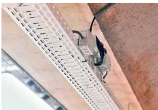
Oberflächenqualität und Pulverbeschichtung qualifizierten die Kabelrinnen für den Einsatz.
