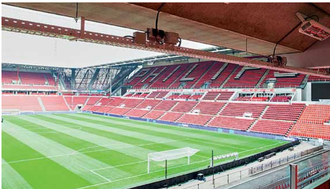
Die Kabel für die LED-Beleuchtung im PSV-Stadion in Eindhoven wurden in Obo-Kabelrinnen verlegt.
