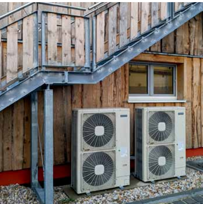
Yutaki S Außeneinheiten vor dem Gebäude
