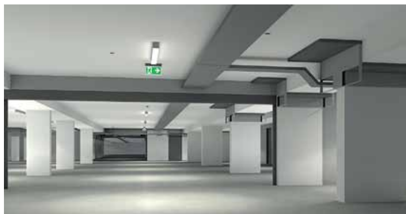
Auch bei der Planung der Elektroinstallationen für die Tiefgarage arbeitete Beerepoot Installatietechnik direkt im 3D-Modell des Architekten.
