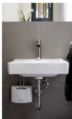
Im Gäste-WC wurde der E-Kleindurchlauferhitzer MCX direkt an die Anschlusschläuche der Armatur montiert.
