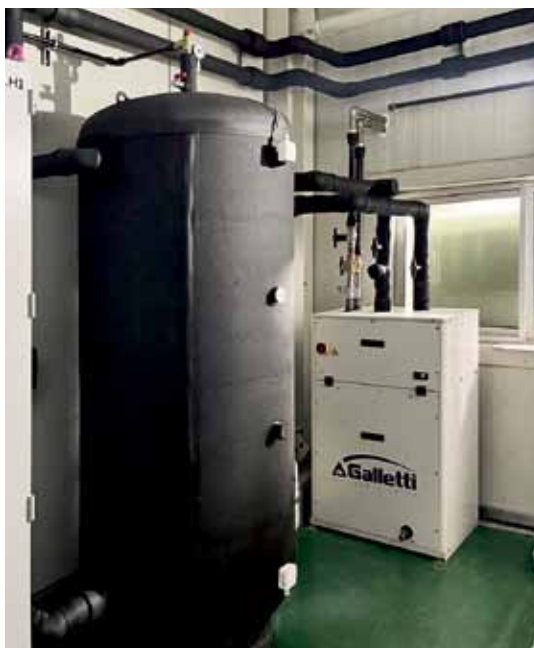
Wassergekühlter Galletti-Kälteerzeuger mit interner Primärpumpe und einem 1.000 Liter Pufferspeicher mit diffusionsdichter Isolierung
