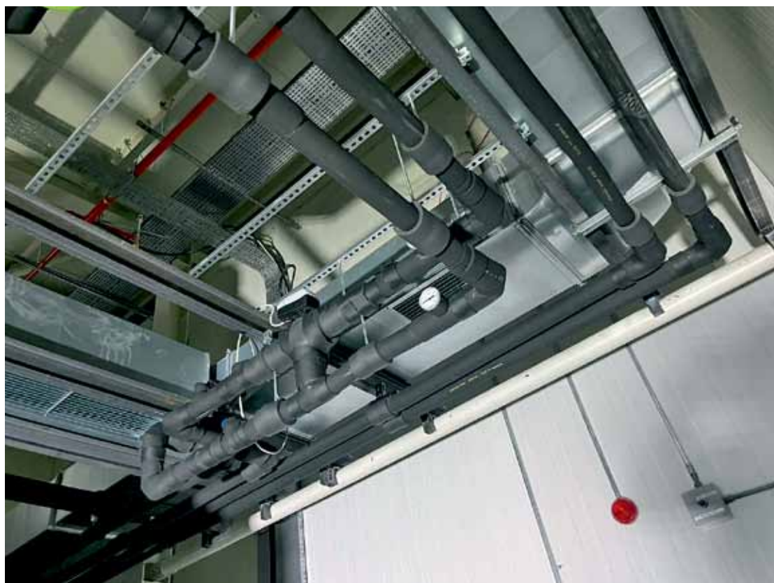
Kaltwasserverteilung zu den Galletti UTN-Gebläsekonvektoren und den Prüfständen
