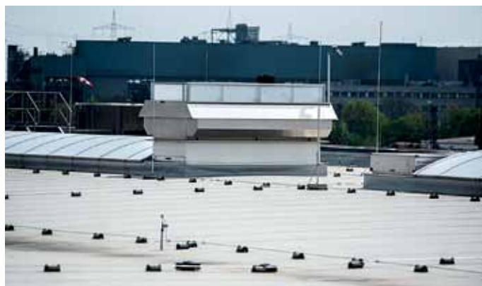
Der regensichere ATI wird neben der Rauchableitung zur täglichen Lüftung eingesetzt: bei schönem und auch bei schlechtem Wetter. Er leistet damit einen entscheidenden Beitrag zur permanenten Wärmeabfuhr aus dem Gebäude.
