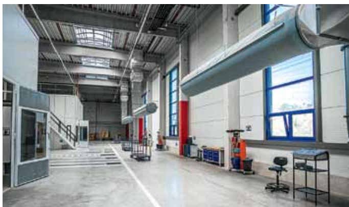
Die Ausstattung der Produktionshalle mit lüftungs- und brandschutztechnischen Colt-Technologien sorgt für ein optimales Gesamtkonzept.
