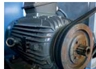
② Die großen, riemengetriebenen Radialventilatoren für die Zu- und Abluft waren ineffizient, laut und bereits korrodiert.
