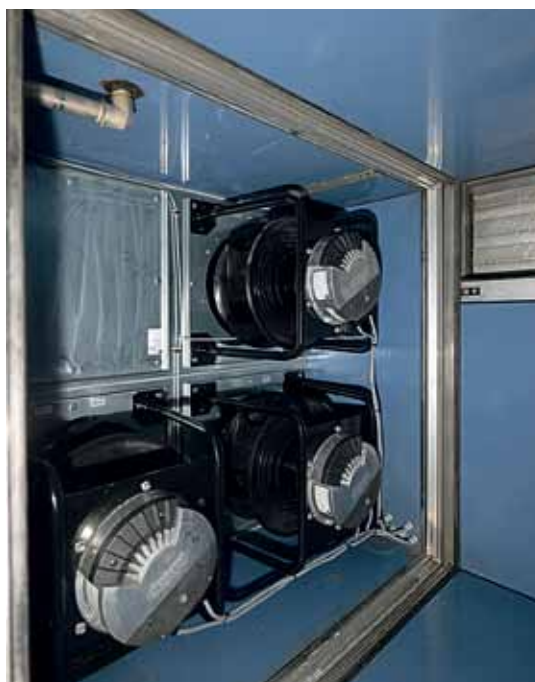
③ Die alten Ventilatoren wurden durch ein FanGrid mit drei Radialventilatoren der neuesten RadiPac-Generation ersetzt.
