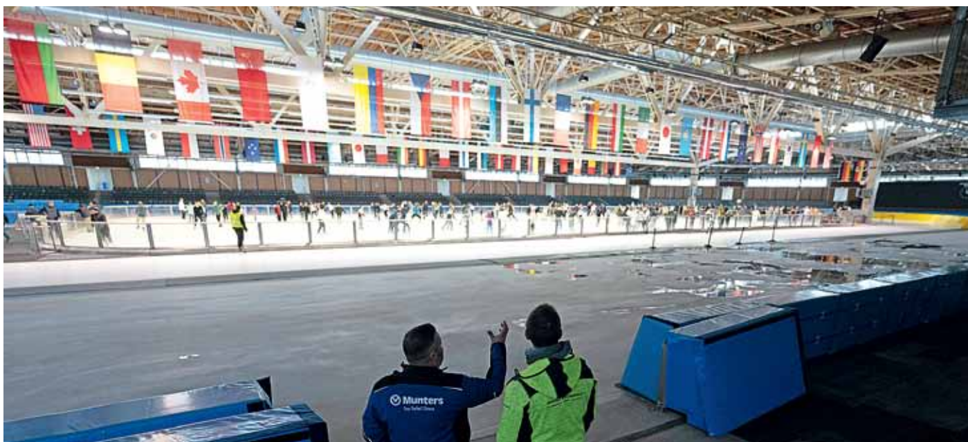
④ Erste Messungen nach dem Tausch der Zu- und Abluft-Ventilatoren zeigten eine Energieeinsparung von insgesamt 52 Prozent für die Anlage.
