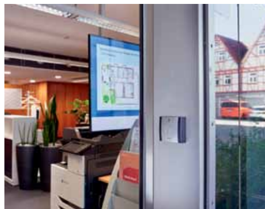
Die Außentüren sowie Zugänge aus der Tiefgarage der Volksbank Backnang sind mit Salto Wandlesern gesichert.
