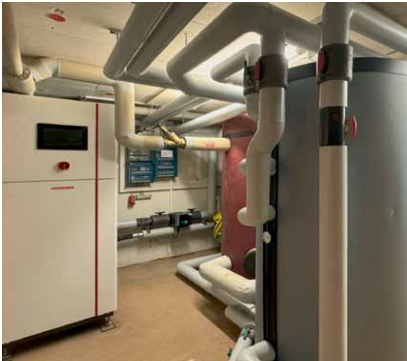
Wärmepumpe im verbauten Zustand
