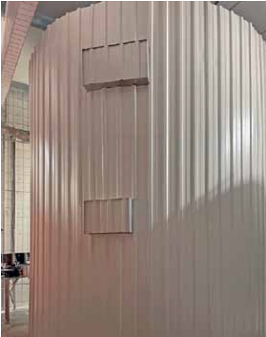
⑤ PCM-Energiespeicher als Kältespeicher /5/: Speichergröße: 83.000 l., mit 32.000 Stck.: heatSel XL ATS -16, Speicherkapazität bei einer Speichertemperaturänderung von 10 K: 3,6 MWh
