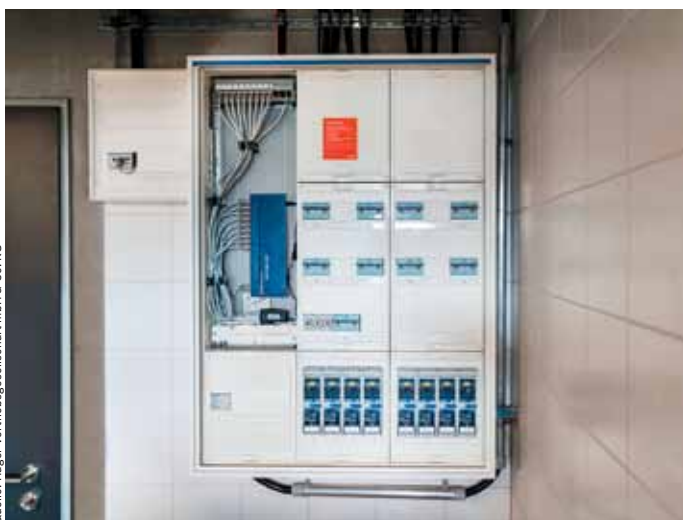
Dreh- und Angelpunkt der Ladeinfrastruktur: Energieverteilung univers Z von Hager
