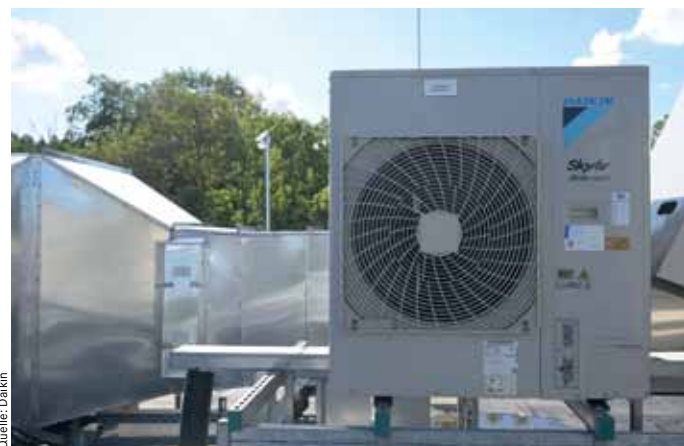
Die zusätzlich installierten Daikin Sky Air Anlagen kühlen den Serverraum.
