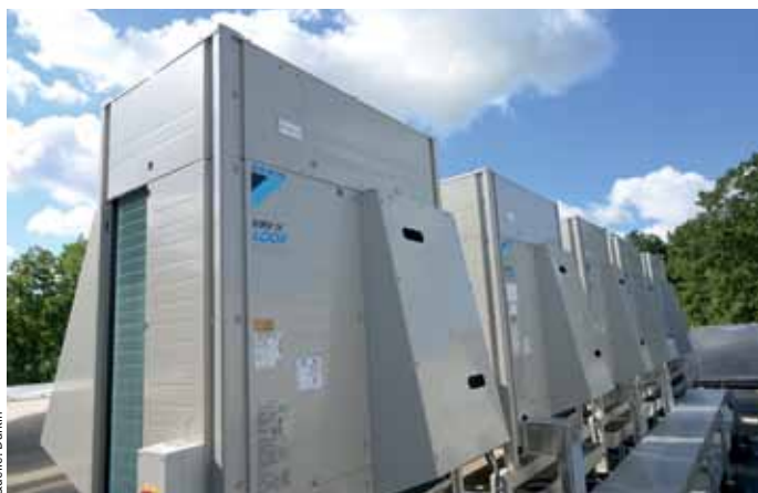
Die Daikin VRV IV Heat Recovery heizt und kühlt die neue Vertriebszentrale von Clage in Lüneburg.
