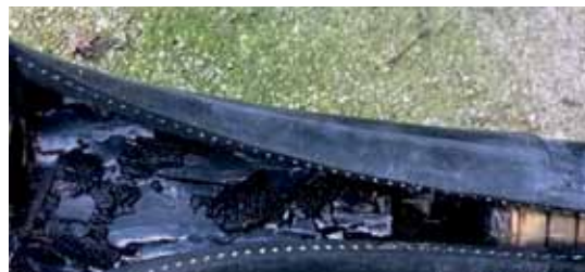
③ Diffusionsoffener Gummischlauch mit deutlichen Magnetitablagerungen auf der Innenseite. Platzen diese ab, kommt es zu Störungen von BHKWs oder Wärmepumpen. Edelstahlwellrohre schaffen hier Abhilfe.
