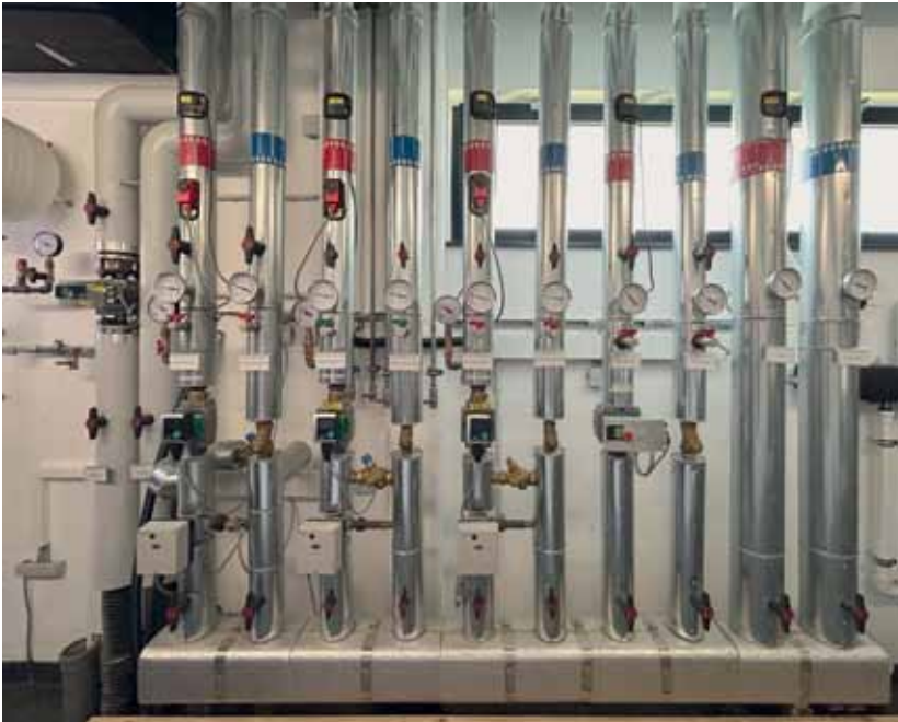
Vor- und Rückläufe der Fußbodenheizungen in dem Schulgebäude
