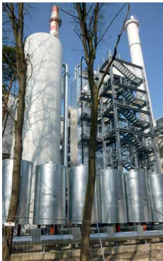
⑥ Mit dem Abhitzekeßel wird dem heißen Rauchgas die Wärme entzogen; die Abwärmeleistung beträgt etwa 3.000 kW und es werden ca. 25.000.000 kWh Wärme gewonnen.
