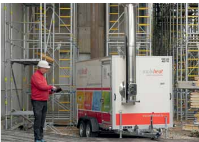
Temporäre Beheizung einer Halle.
