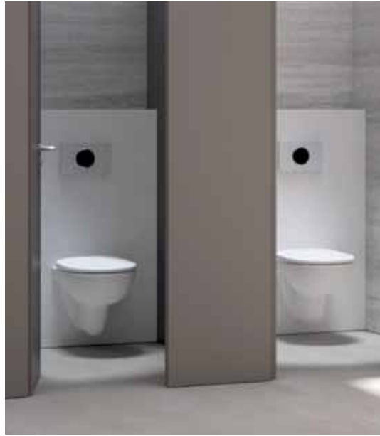
Mit automatischen Spülauslösungen lassen sich auch in WC-Anlagen die Handkontakte reduzieren.
