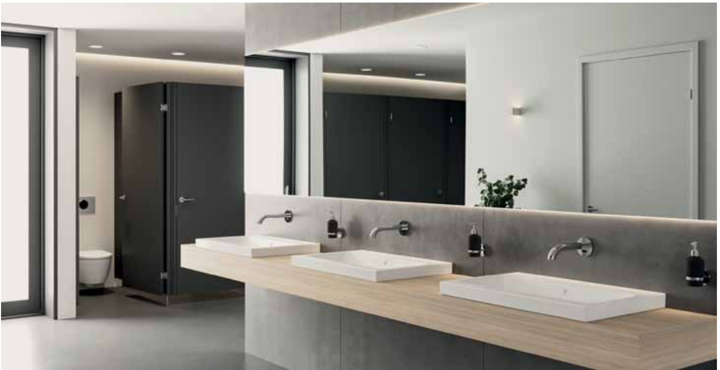
Reihenwaschanlagen mit glatten, reinigungsfreundlichen Oberflächen erleichtern die Reinigungsarbeiten.
