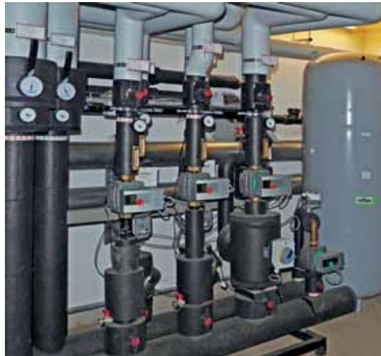
Warmwasseranlage im Keller
