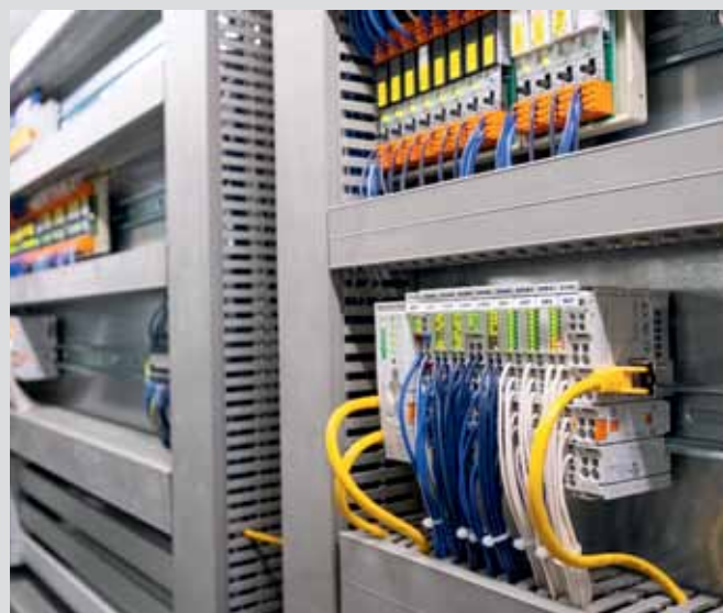
Mit einem modularen Automatisierungssystem wie dem Wago I/O System 750 sind Gebäudebetreiber im Hardwareaufbau flexibel.
