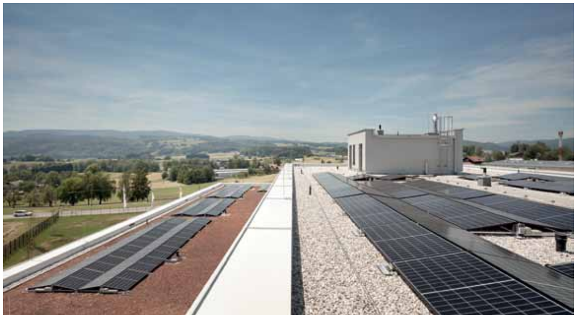
Das TGA-Konzept erfüllt modernste Kriterien des Green Deals. Die am Dach installierte PV-Anlage zum Beispiel eliminiert die Betriebs-CO 2 -Emissionen. Der regenerative Strom deckt den Eigenbedarf zu 100 %, überschüssiger Strom wird ins Netz eingespeist. Die Geothermieanlage dient als zusätzliche Energiequelle.
