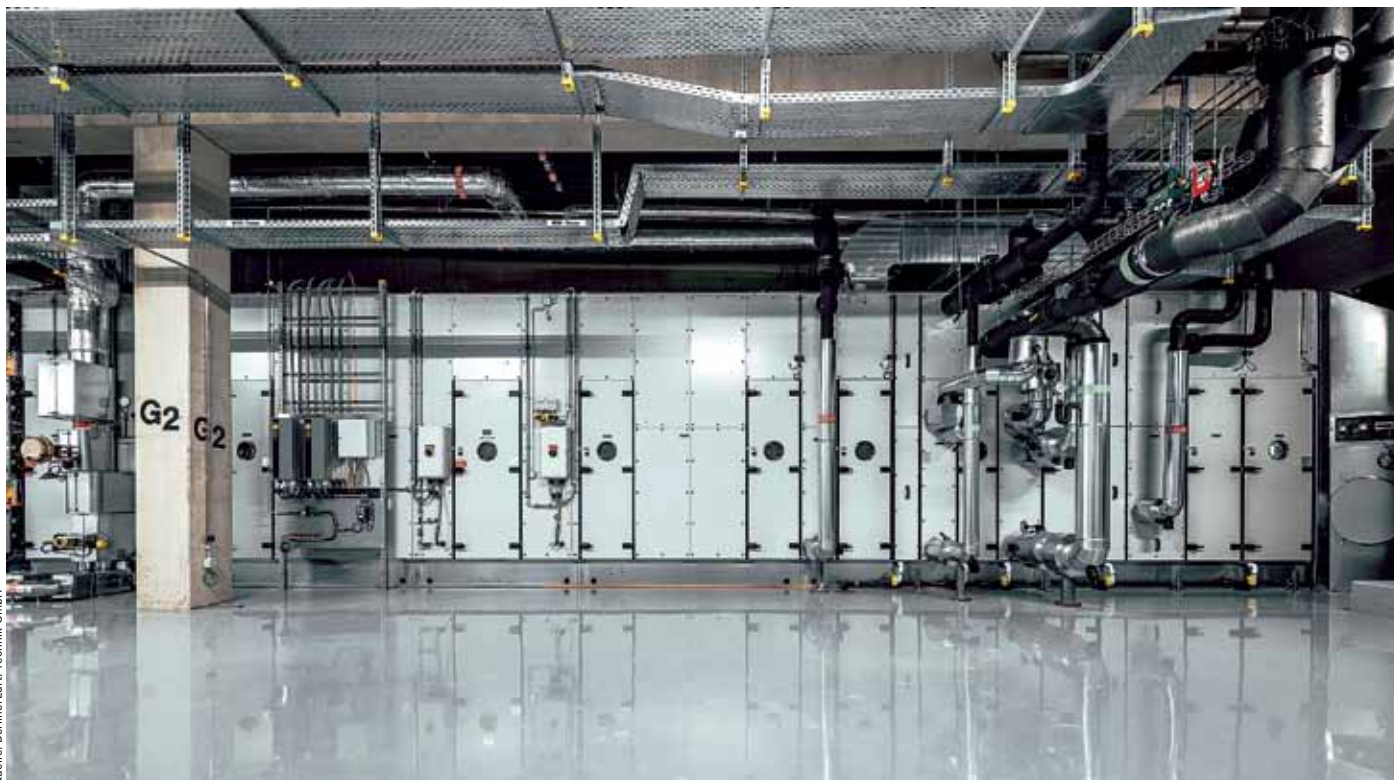
Quelle: BerlinerLuft. Technik GmbH
