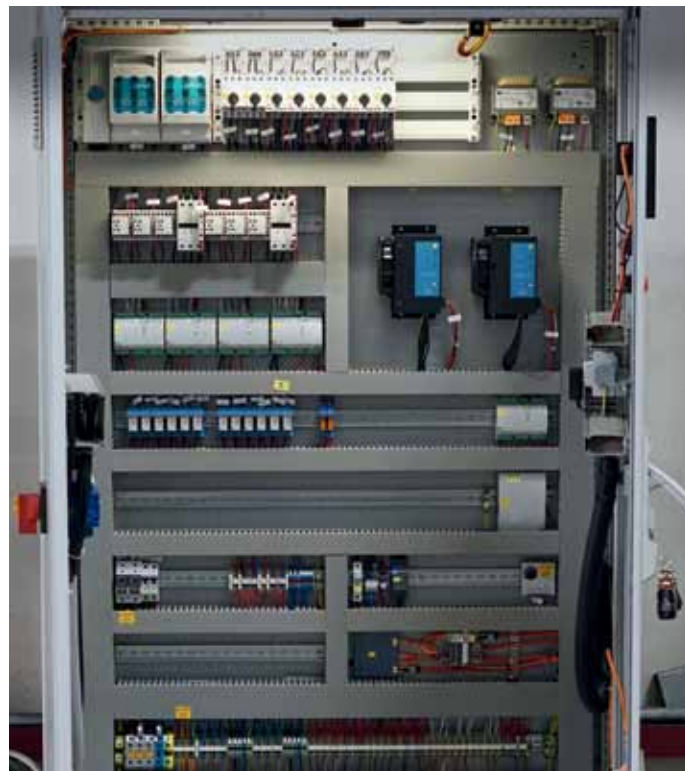
Über eingebundene Leistungssteller werden verschiedene Lüfter geregelt.
