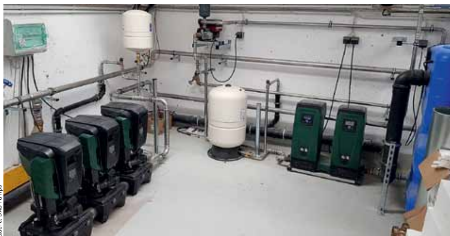
Konzentrierte Pumpenkraft im Bürokomplex Lanolinfabrik, links drei DAB Eskybox Max zur konstanten Druckerhöhung innerhalb der Gebäude, mittig und rechts zwei DAB Eskybox mit 480 l Vorlagebehälter zur Bewässerung der Dachbegrünung
