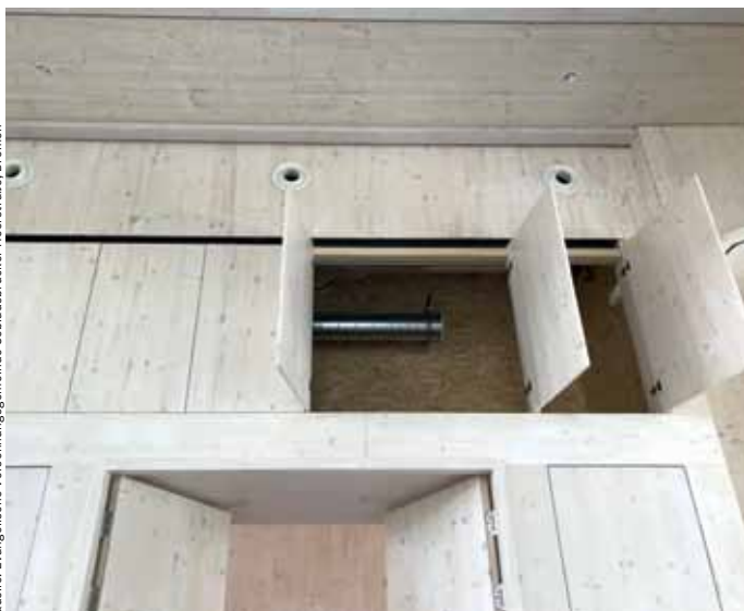
Die Lüftungsleitungen und Weitwurfdüsen sind wartungsfreundlich in den Oberschränken integriert.
