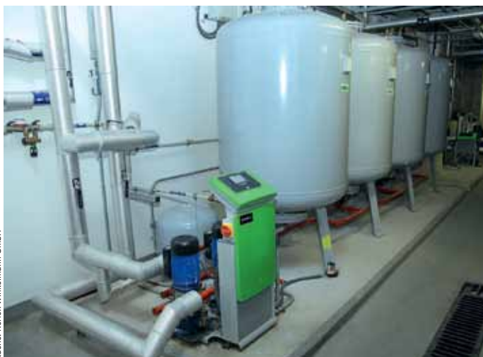
Skid-Lösung bestehend aus Variomat Grund- und Folgegefäßen, zwei Entgasungsanlagen und einem Steuergefäß
